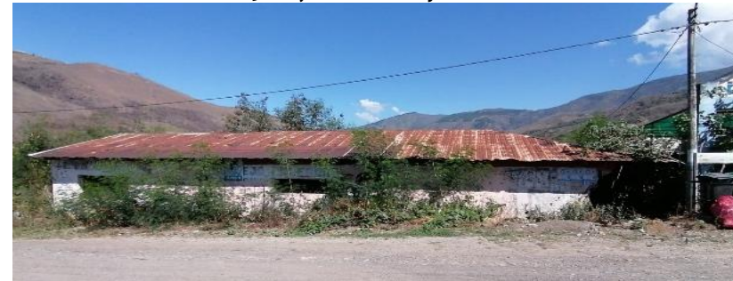
FOTOGRAFIA N° 2.6-15: Edificación en muy mal estado de conservación
