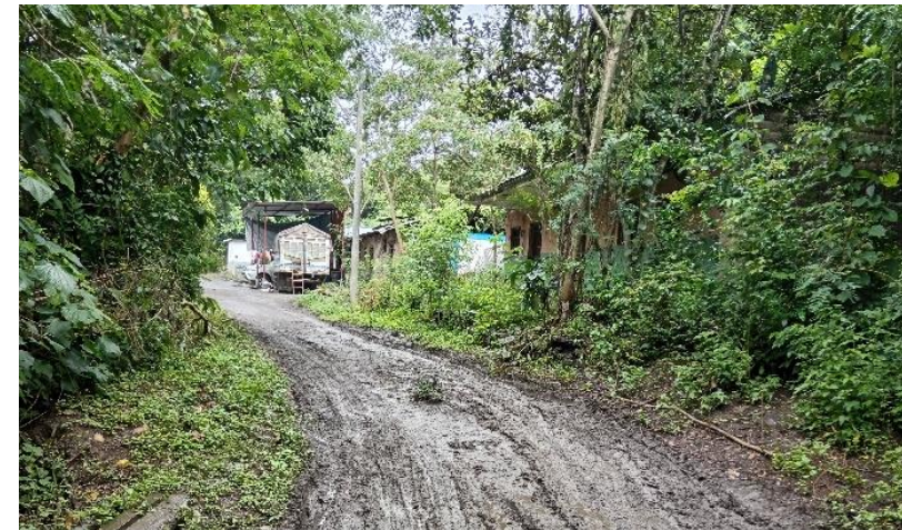
FOTOGRAFIA N° 2.6-22: Estado de conservación malo de vías
