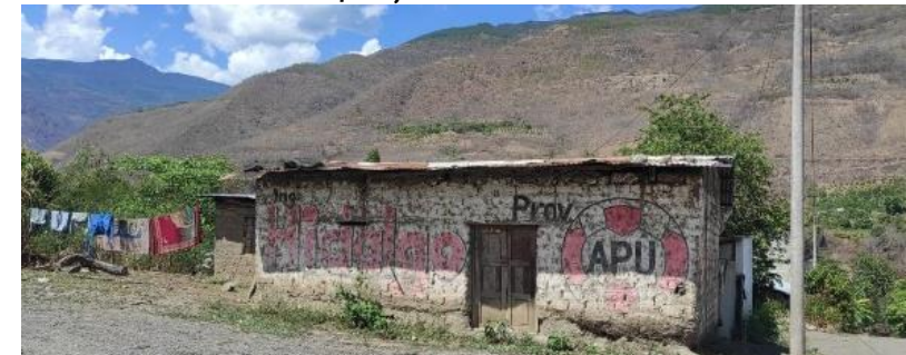
FOTOGRAFIA N° 2.6-14: Edificación en mal estado de conservación
