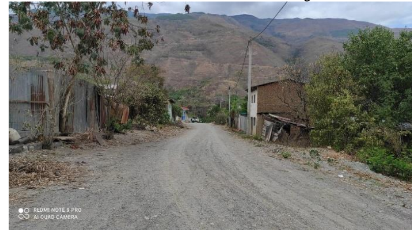
FOTOGRAFIA N° 2.6-21: Estado de conservación regular de vías
